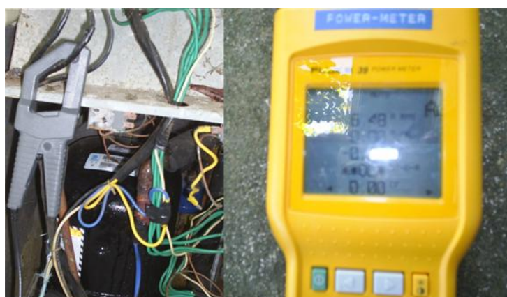
รูปที่ 5.6 แสดงการตรวจวัดปริมาณการใช้พลังงานไฟฟ้า
