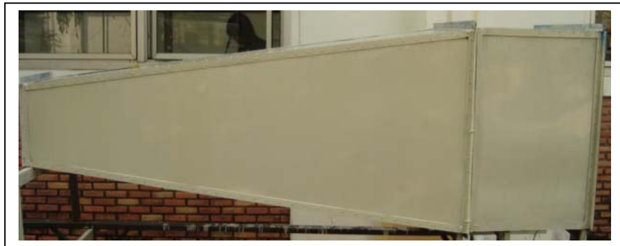
รูปที่ 4.13 DIFFUSER ที่สร้างเสร็จสมบูรณ์
